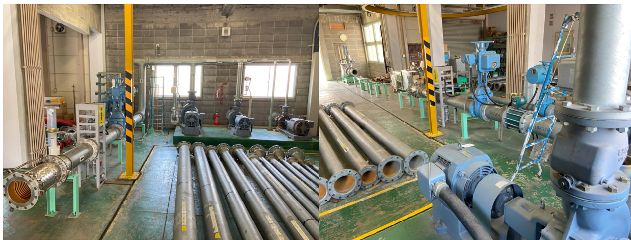
図 1 バルブ性能試験装置写真
